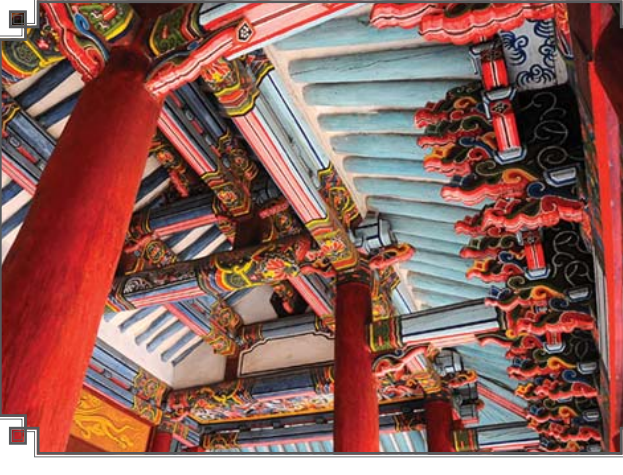
단청은 조선건축에서 오래전부터 리용하여은 장식미술의 한 종류로서 민족적정서가 깊고 개성이 뚜렷한 문화재이다.
